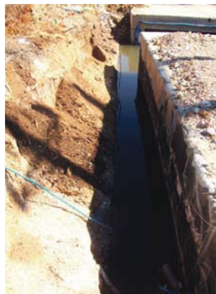
Ο αγωγός της ΕΥΔΑΠ η μη μετακίνηση του οποίου αποτελεί εμπόδιο για την συνέχιση του έργου!!!
